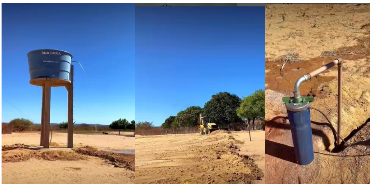
Figura 8 - Ampliação do sistema de abastecimento de água loc. Caldeirãozinho
